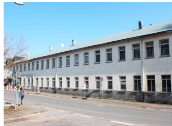
Abb. 5.129 | Sanierungsbedürftiger Leerstand, Vesserstraße
